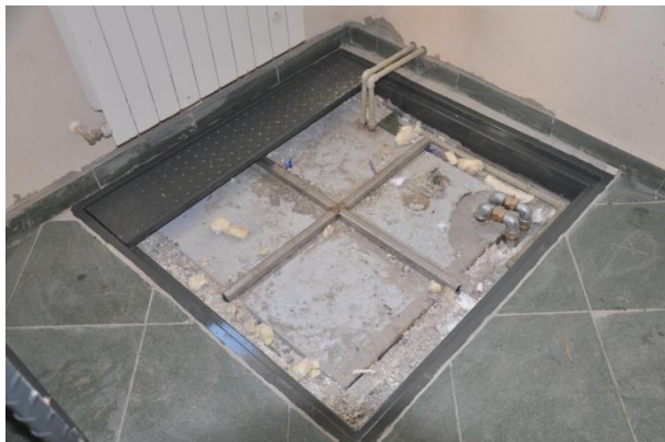
Zbiornik wody ciepłej
