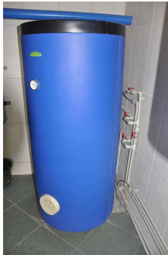
Istniejący system ogrzewania wody do mycia
