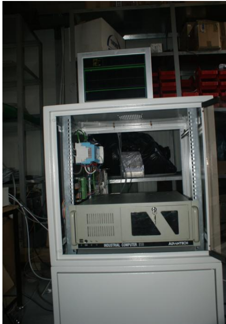
Fot. 2 Szafa sterownicza
