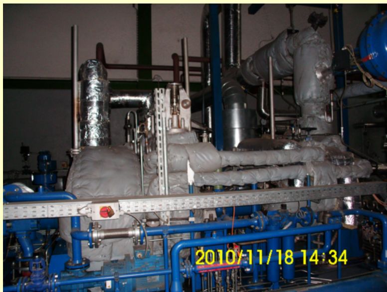
Dwukorpusowa turbina przeciwprężna firmy Spilling
