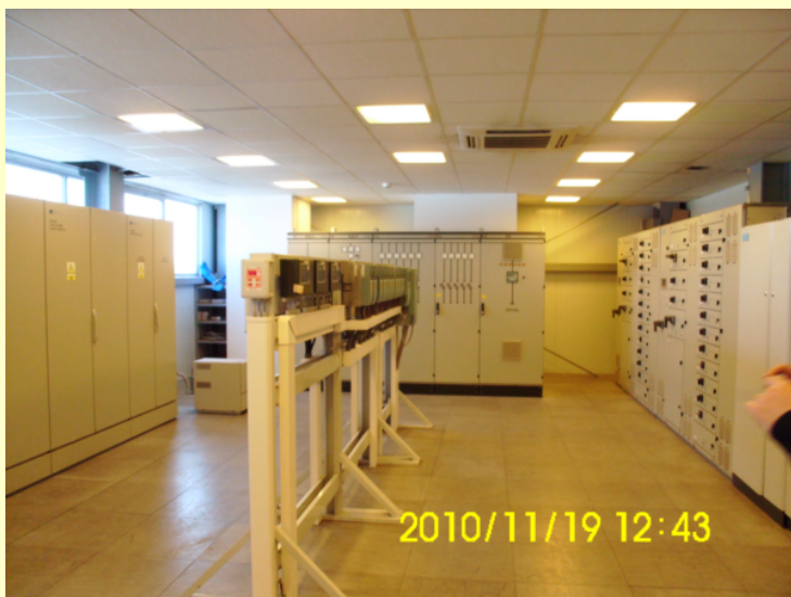
Szafy ze sterownikami
