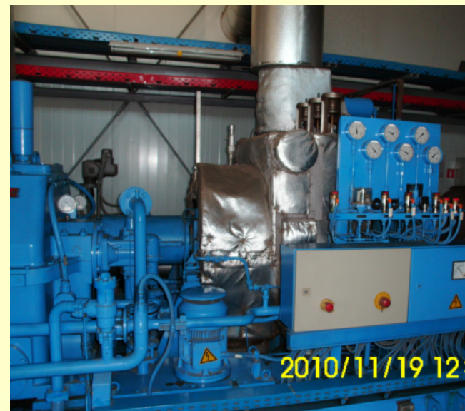
Turbina parowa z generatorem firmy Tuthill-Nadrowski
