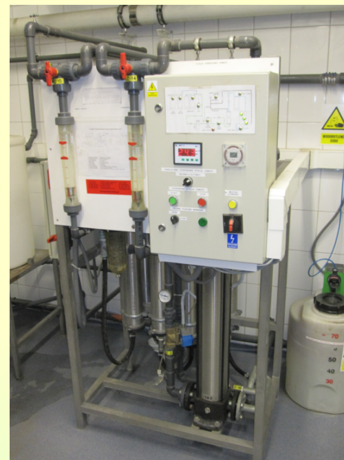
Stacja uzdatniania wody
