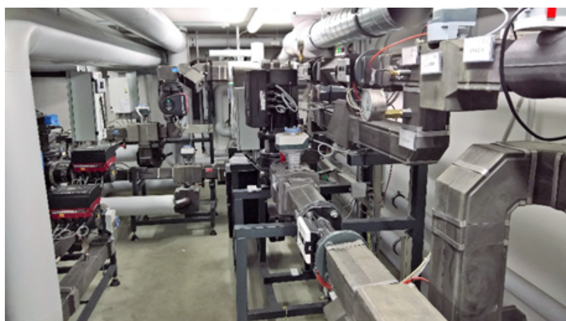
Rys. 2. Rozliczeniowy węzeł ciepłowny dla budynków plusenergetycznych Źródło: © Stefan Simonides, BTU Cottbus-Senftenberg, Niemcy
